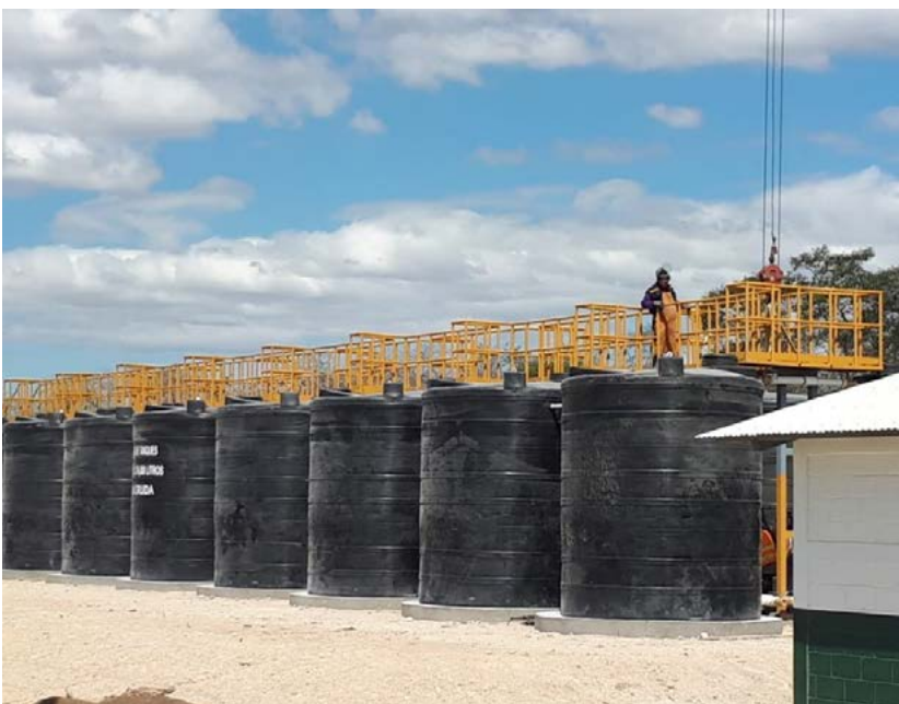
Sistema de bombeo Boosterpaq y almacenamiento de agua para granjas de la industria avícola, ubicada en el municipio Larreynaga-León, con esta obra se garantizó el suministro continuo de agua para la producción y el procesamiento del rubro. Se utilizaron equipos de bombeo con variadores de frecuencia para reducir el consumo energético de la planta. Cada finca tiene una capacidad de almacenamiento de 374,000Lts y con capacidad de manejar 239gpm.
