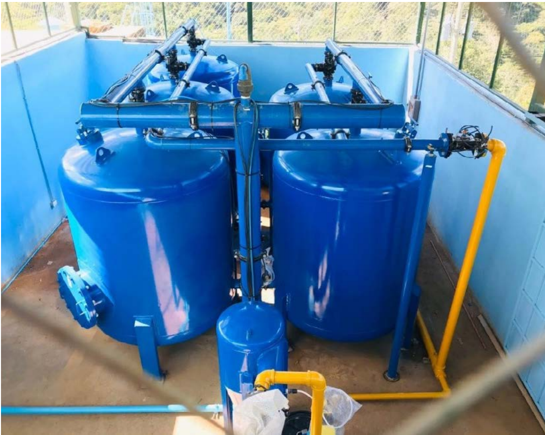
La Planta de Tratamiento de Agua Potable para consumo de la comunidad San Juan de Rio Coco, ubicada en el departamento de Madriz, esta planta tiene una capacidad de 108 m 3 /h. garantizando agua de calidad a un aproximado de 1,769 familias.
